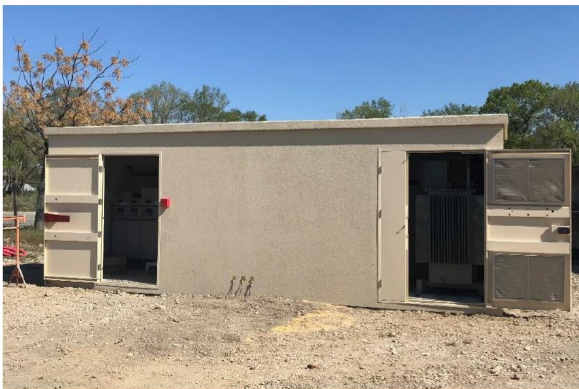
Illustration 16 : Photographie d'un poste de livraison/transformation
